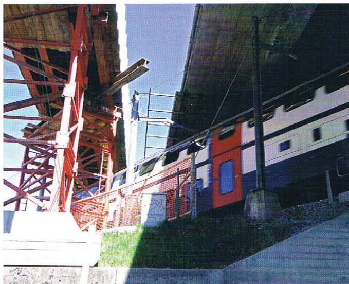
Damit der Bahnverkehr nicht beeinträchtigt wird, mussten die Arbeiten an der Brücke Stadtergasse in die Nacht verlegt werden.
