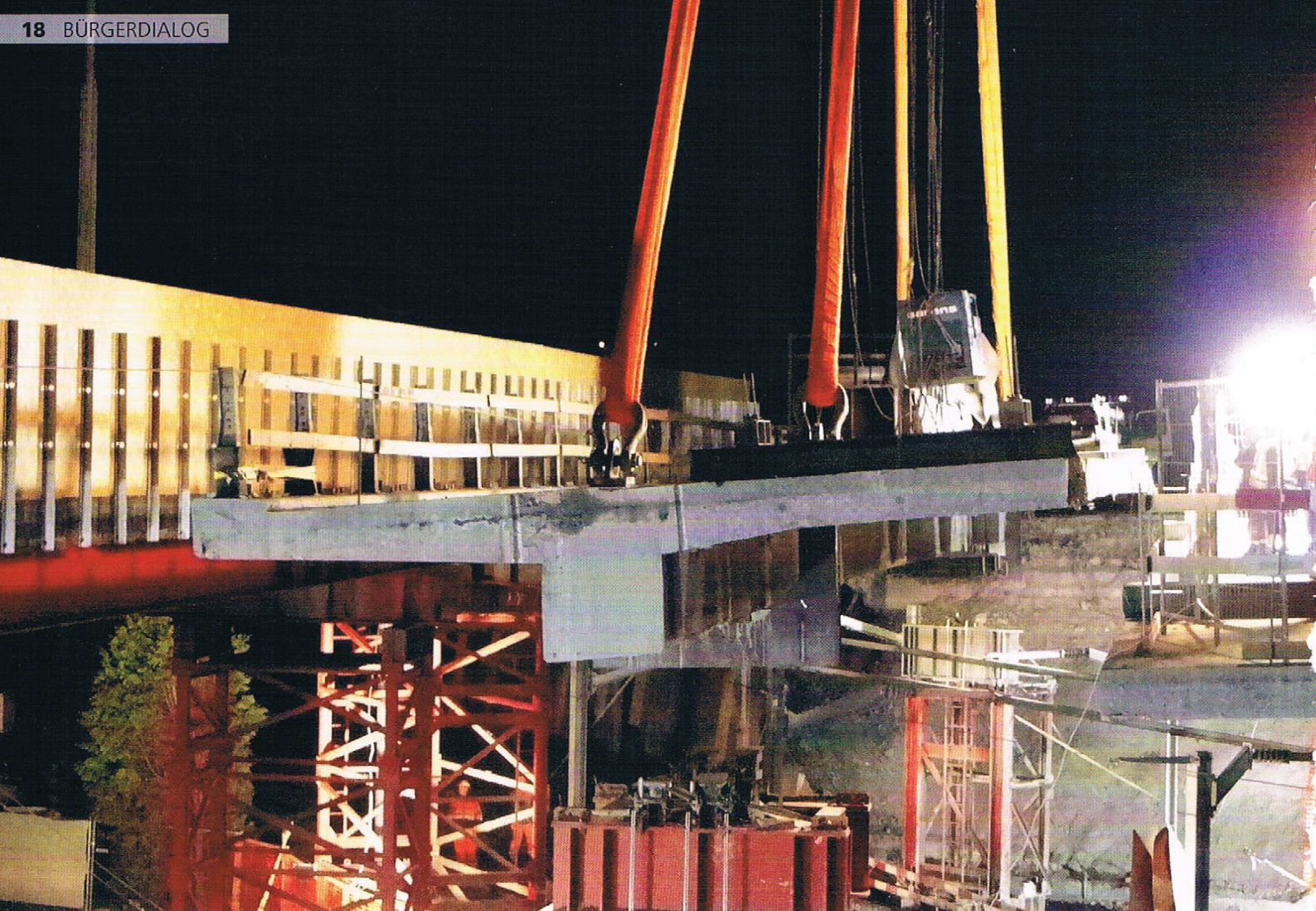
Lärmintensive Nacharbeiten wie an der Stadtergasse führten zu Bürgerbriefen.
